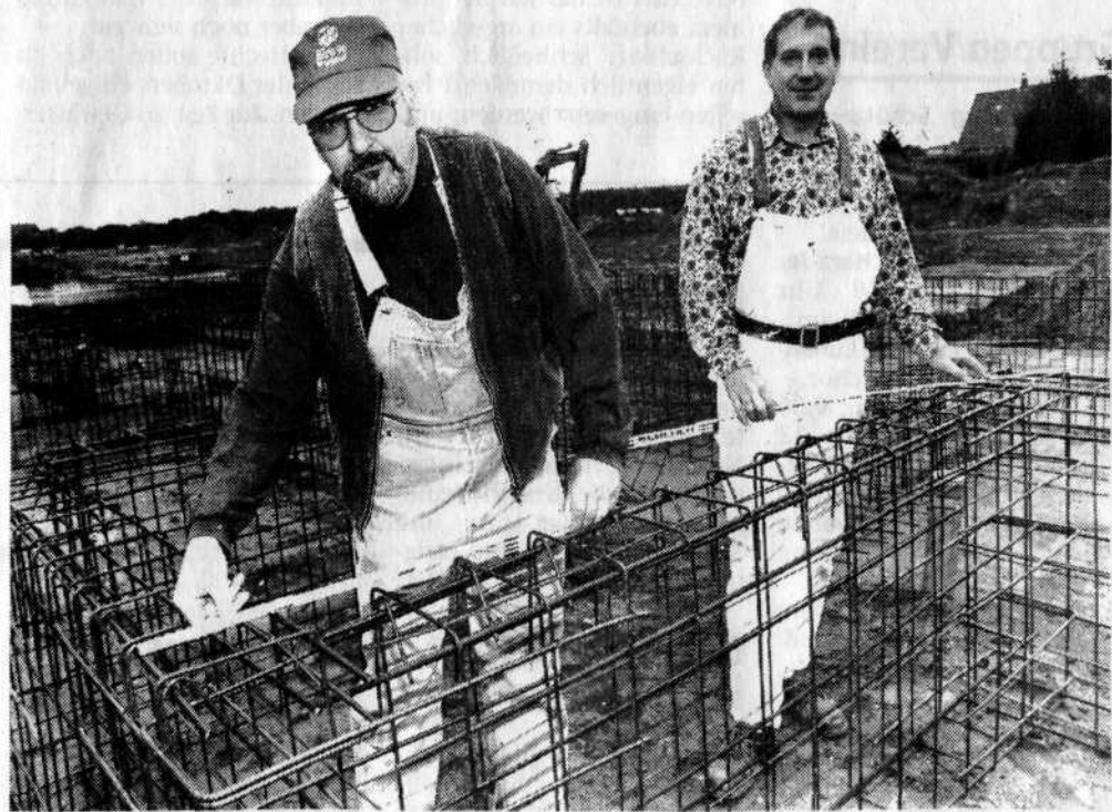
Bald stehen die ersten Fundamente der Ökohäuser. Zur Zeit bereiten die Häuslebauer Manfred Rahn (links) und Manfred Wulfert die nötigen Drahtgeflechte vor. (Foto: Ingo Neubold)
